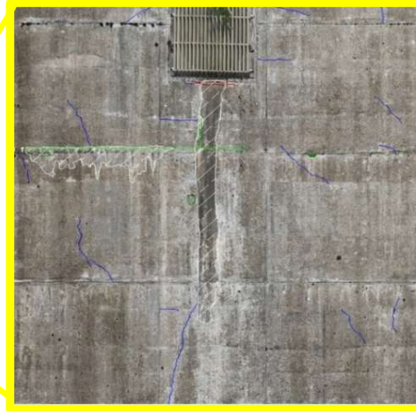
ダム下流面 堤体変状図
