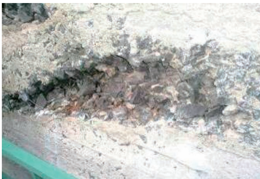
写真－1.7 上流面の劣化状態
