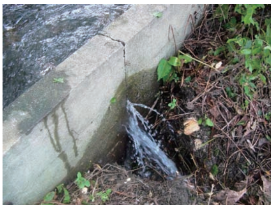
写真－1.1 目地部からの漏水の状況
