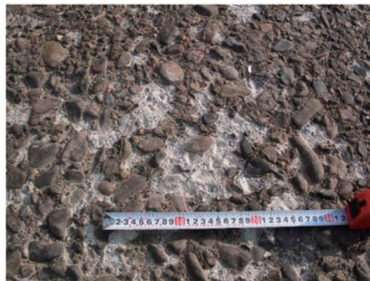
写真－1.2 摩耗の状況
